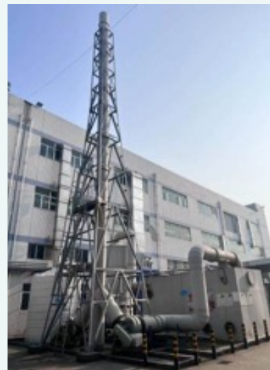
無錫廠廢氣處理設備
