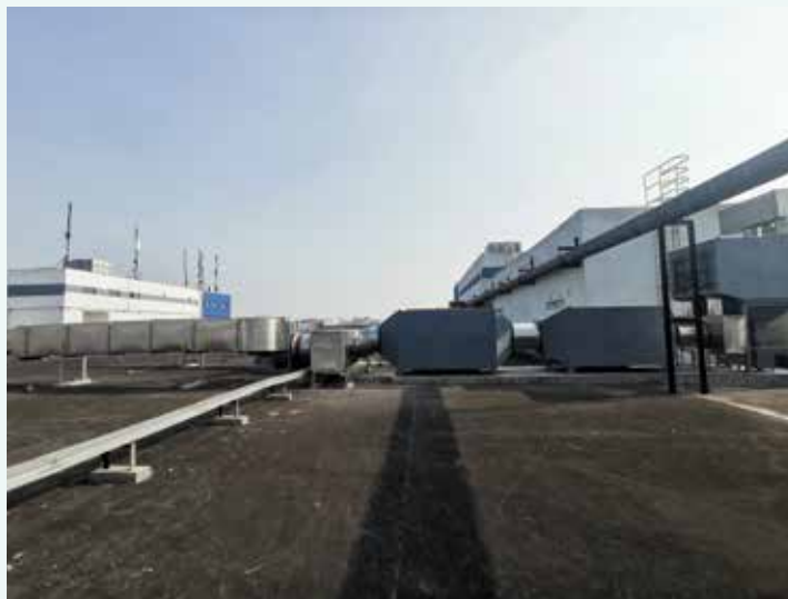
成都廠有機排氣設備
