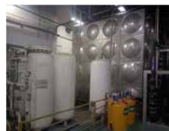
成都廠 RO 濃縮水回收系統
