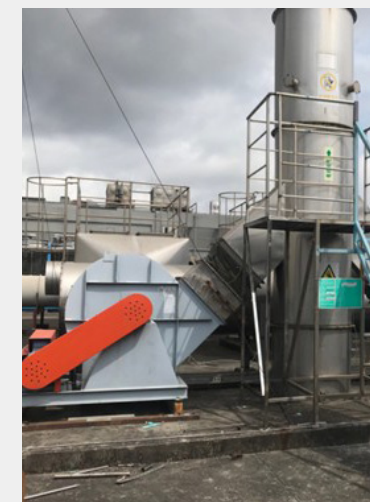
深圳廠有機廢氣設備
