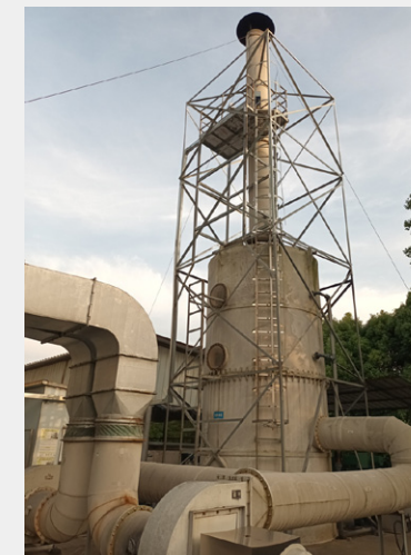
無錫廠噴淋吸收塔設備
