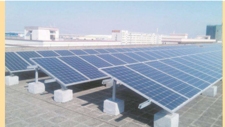
屋頂太陽光電系統
