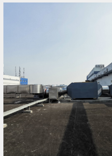
成都廠有機排氣設備
